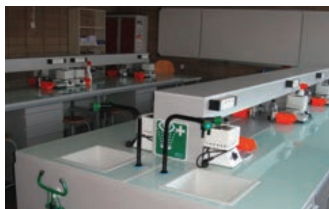
LA PAILLASSE CENTRALE AVEC PONT D'ENERGIE
